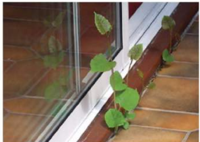
.... en kan forse schade opleveren
